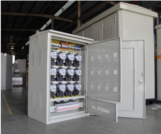
TỦ ĐIỆN CÔNG TƠ
