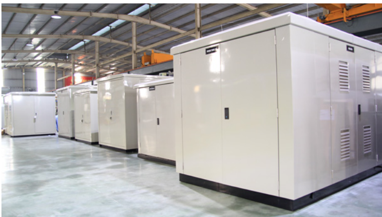
TRẠM BIẾN ÁP HỢP BỘ
